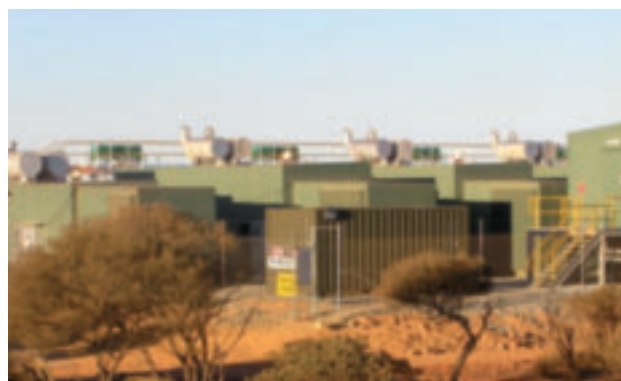
В Западной Австралии, шесть электростанций Cummins QSV91 обеспечивают непрерывное питание в шахте по добыче цинка и меди
