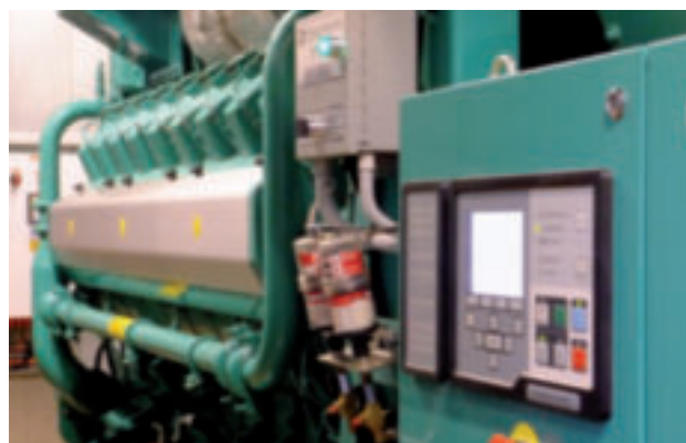
Электростанции QSV91 работают на обедненной смеси используя газовые двигатели Cummins с искровым зажиганием
